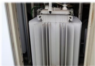
変圧器(トランス)
