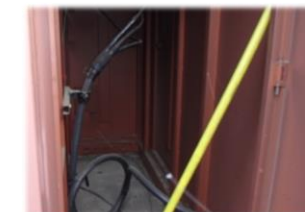
高圧ケーブル
